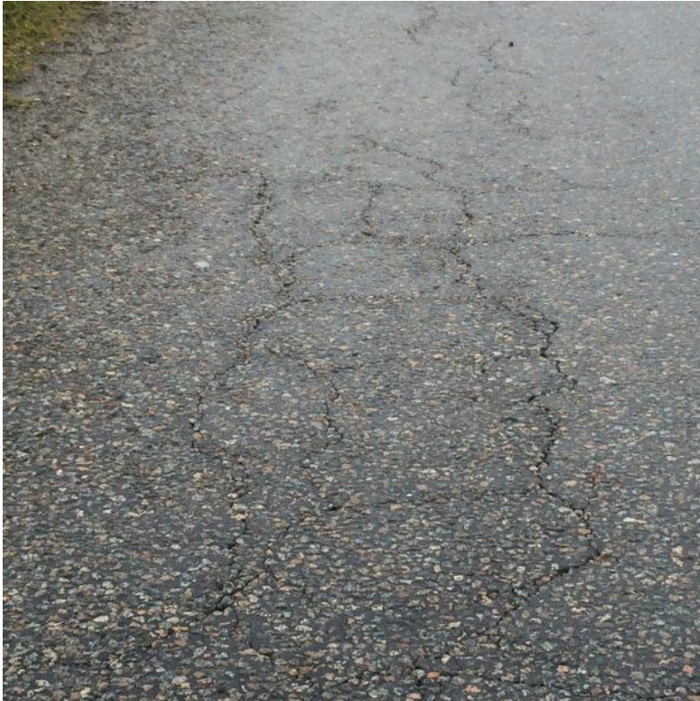
Eksempel på et partielt skadet område på en vejstrækning.
